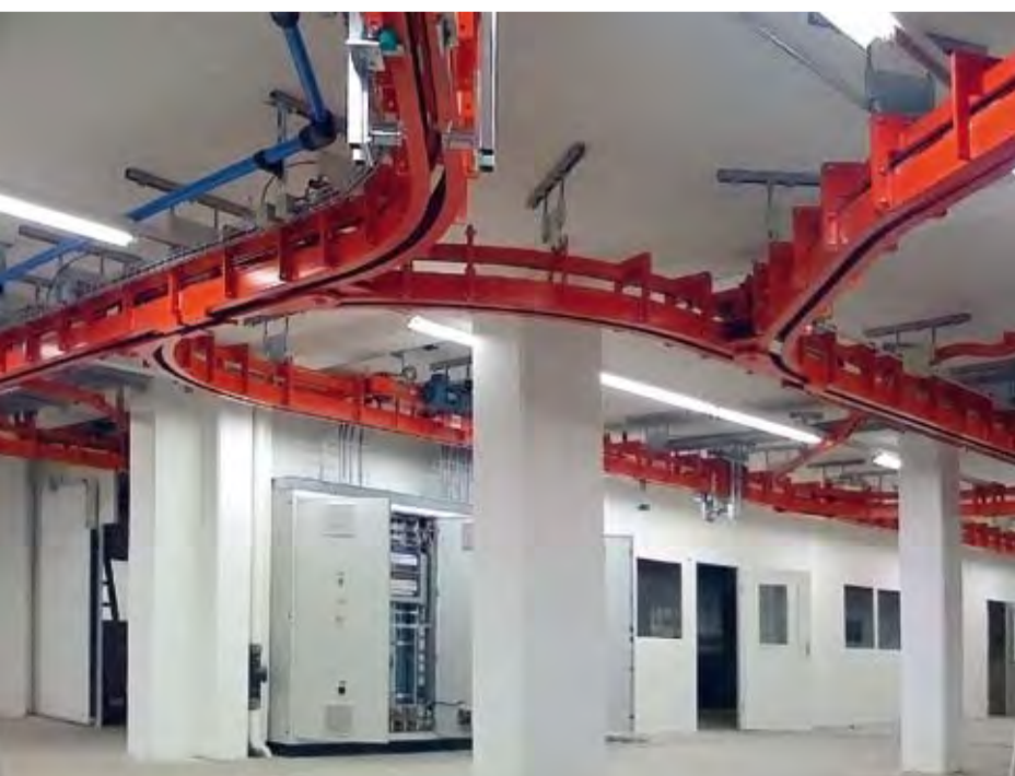
Des données RFID permettent d'acheminer et de traiter les pièces selon les ordres de fabrication des machines.
